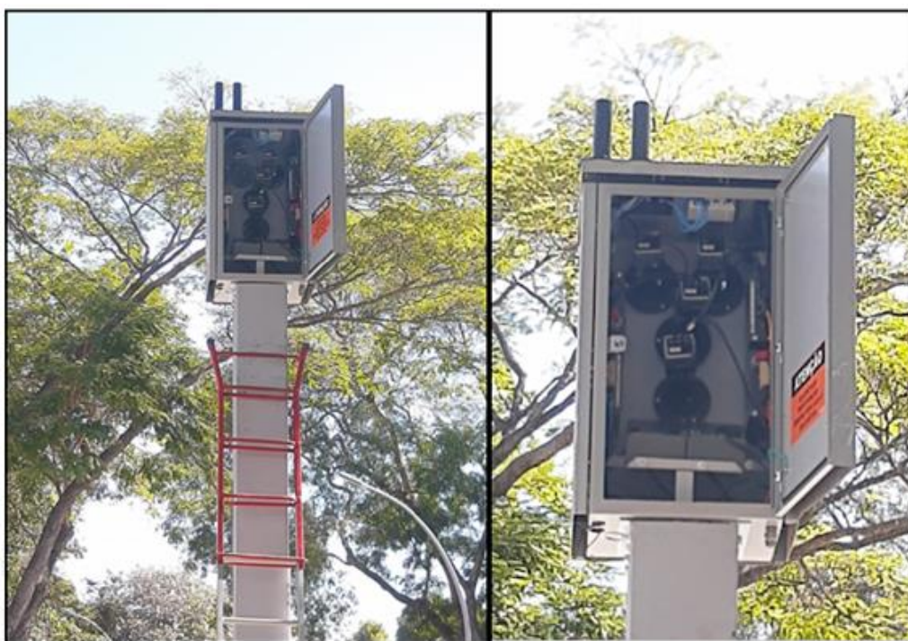
Figura 2 – Vista interna do gabinete (Equipamento instalado no teste)
